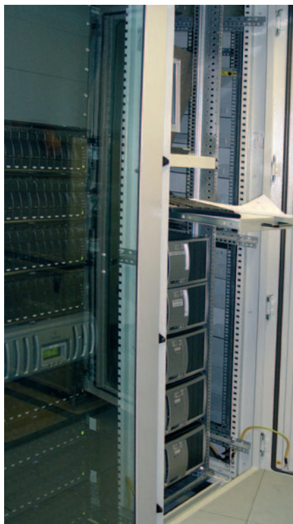
Bild 7. NetApp-Cluster (L.) und Digas-Speicher im ZGR des ORF-Landesstudios Salzburg
